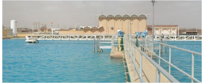
La Planta de Tratamiento de Agua de Osage
